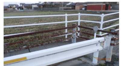
広陵高校前の道路について、全面舗装を求める声が出ています。このたび歩道北側のフェンスのペンキ塗りができましたが、この歩道クランクはそのままです。
